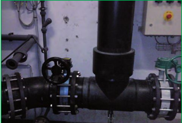
Rohrleitungen - von LS konstruiert, gebaut und montiert ...
